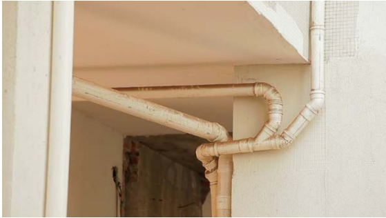
Figura 12. Flexíveis instalados para permitir As operações
